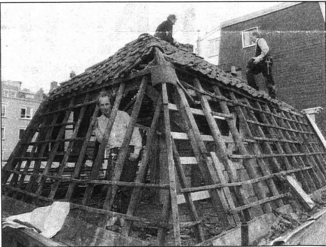
Het Polderhuis op de Rustenburgerstraat in de Pijp krijgt een nieuw dak.
